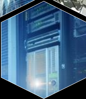
Data centers (IDC & DCI) CORD, Edge DC
